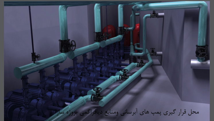
موتورخانه پروژه کمال (ولایت)
